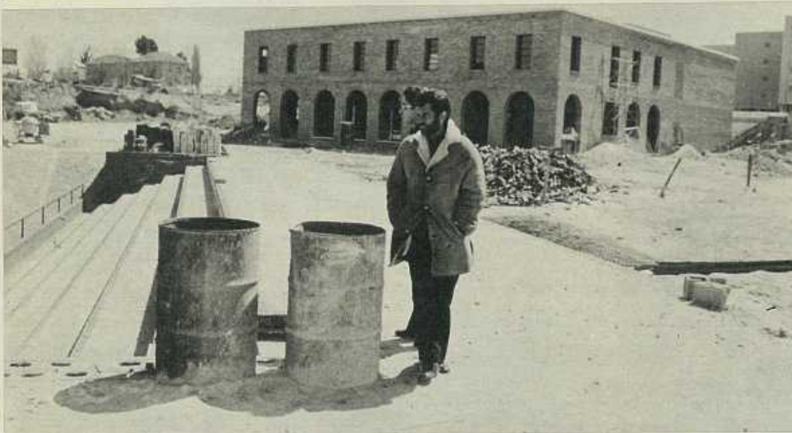
Y éste es, por su parte exterior, el original edificio a que nos hemos referido. Dentro, aparte de las pistas de «squash», se incluirán los correspondientes vestuarios y una cafetería.
